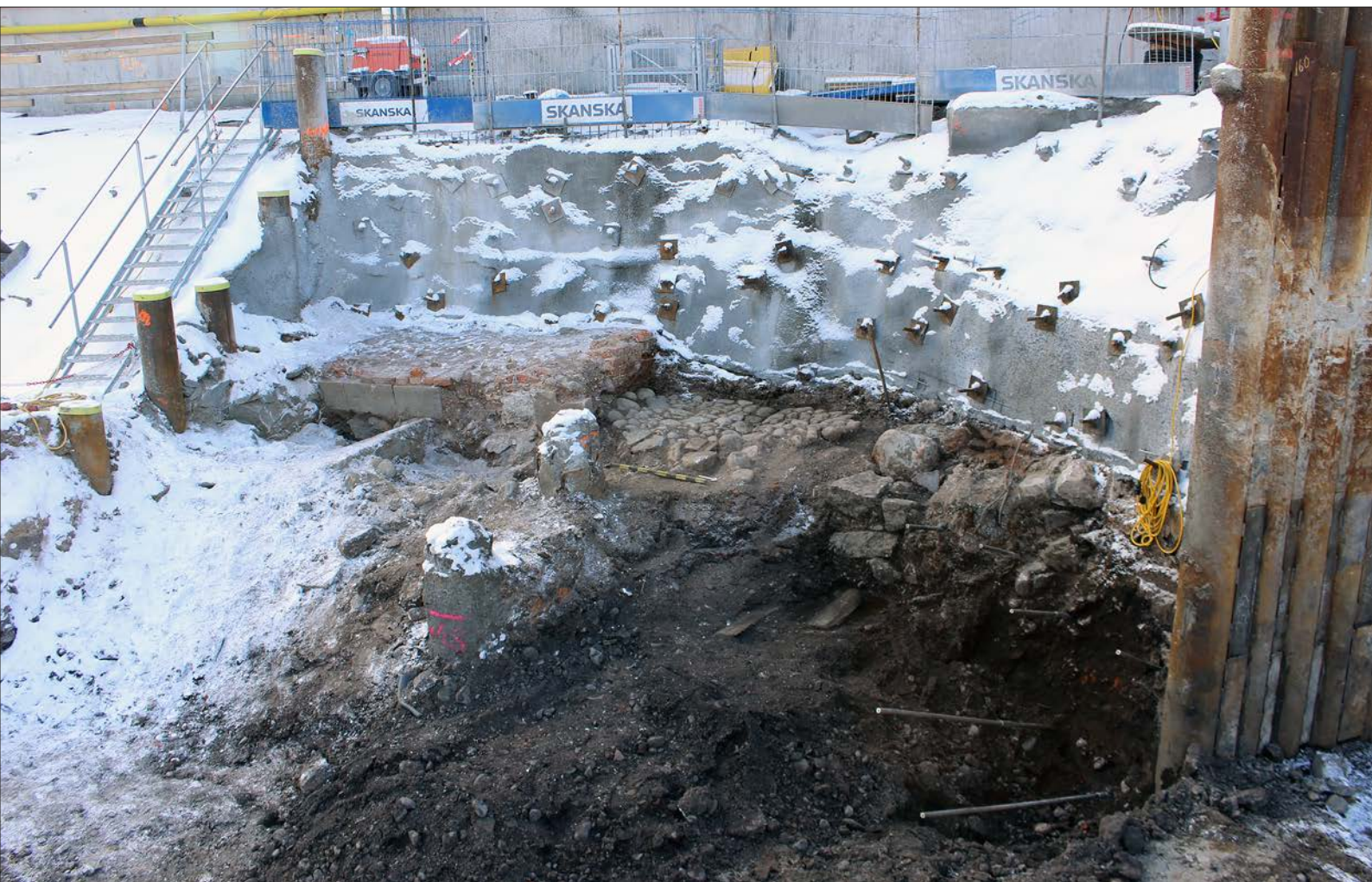
Figur 206. Kontextgrupp 20 som utgörs av nordöstra hörnet till ett av kontorsrummen beläget i anslutning till vågen. Höger i bild syns rester av den norra portingången in till Ryssgården. Foto från öster.
