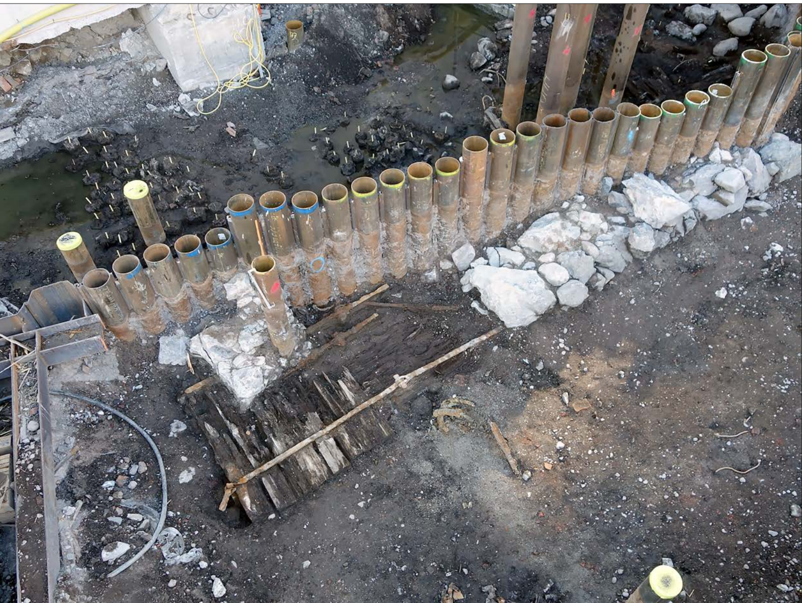
Figur 235. Till höger i bild visas grundstenarna till en magasinsbyggnad som anläggs under 1730-talet. Till vänster visas rustbädden och några av dragförbanden som höll samman stengrunden och i bakgrunden bakom rörsporten syns några av grundläggningspålarna som hela byggnaden vilade på. Foto från nordväst.
