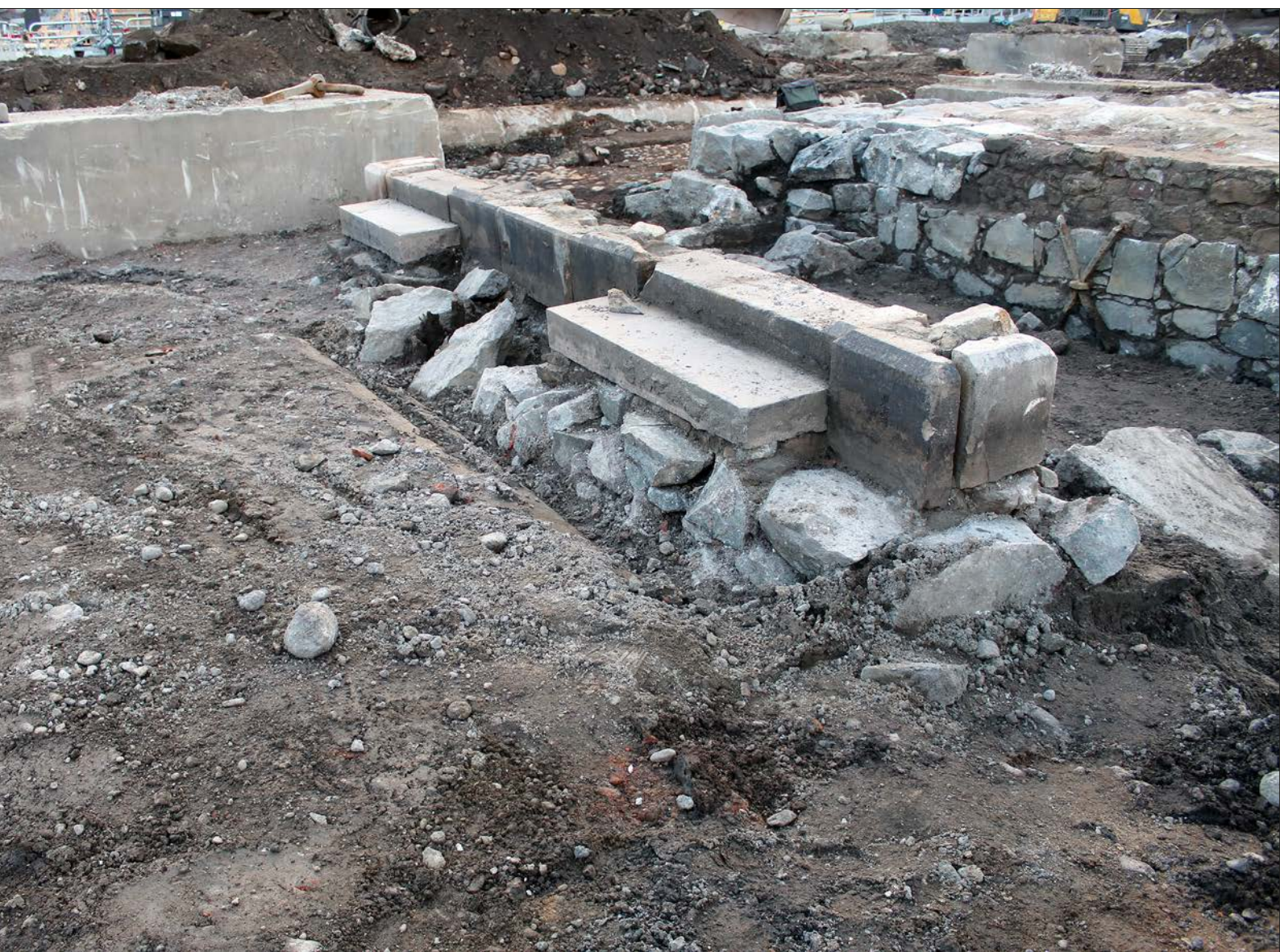
Figur 341. I bakgrunden syns del av Östra passagebron och i förgrunden visas grundmurarna och trapporna till en tillbyggnad. Byggnaden har bland annat fungerat som vaktstuga för att förhindra stölder i Järngraven på Saltsjösidan. Oftast sköttes vakt-hållningen i Järngraven av de äldre järnbärarna. Foto från nordöst.
