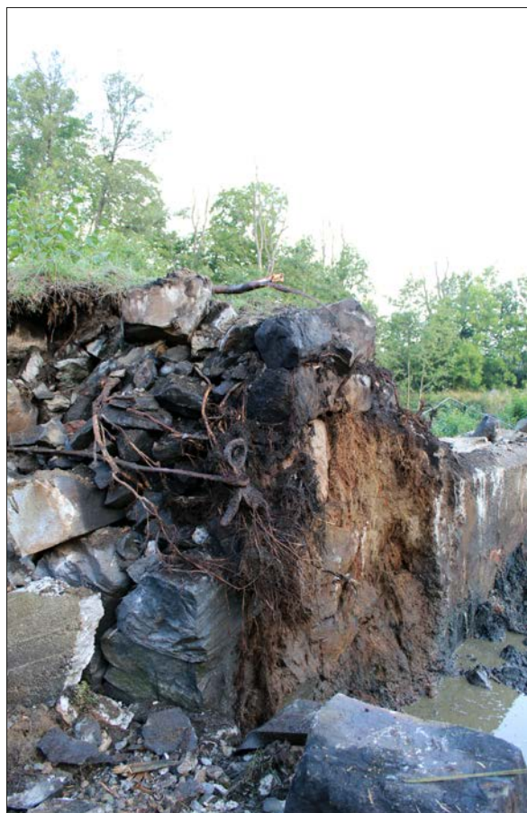
Figur 21. Fundamenten vid södra utskovet hade byggts ut mot öster. Bakom utbyggnaden fanns den gamla ytan med släthuggna stenar och ankarslut från 1800-talets mitt. Foto från sydost.
