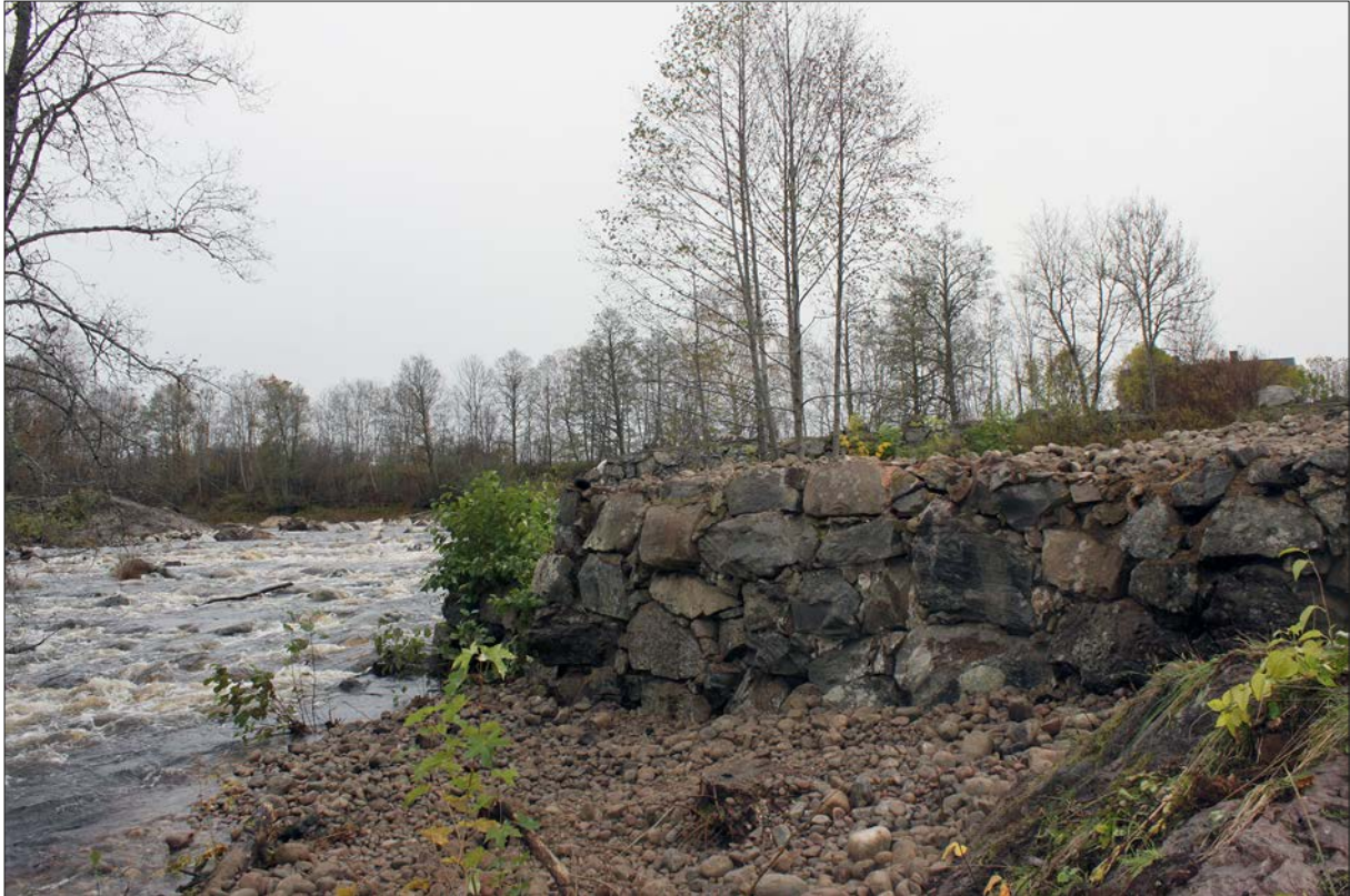
Figur 30. Ned mot strömmen i väster var husgrunden över två meter hög. Foto från sydväst.
