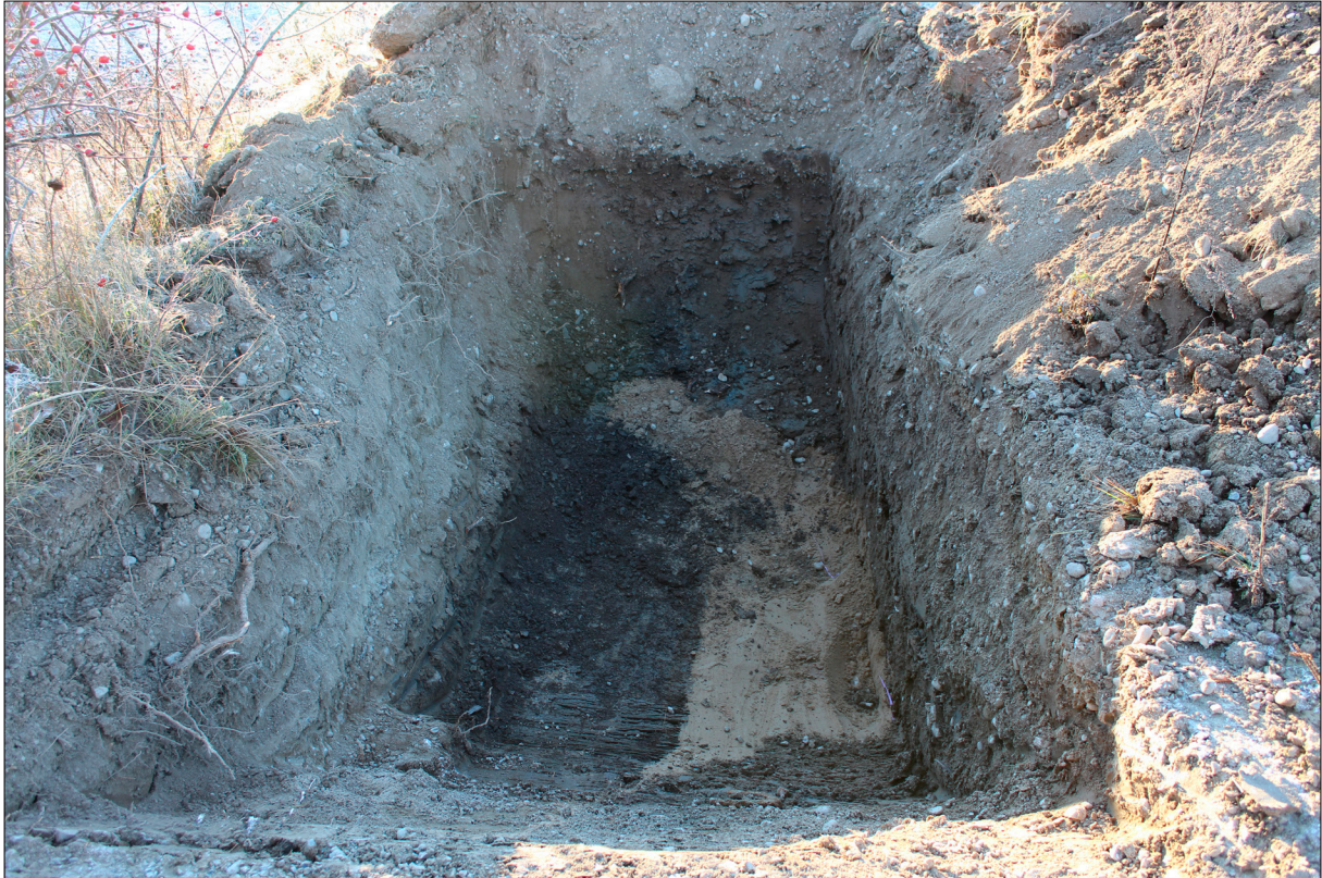
Figur 22. Vid schaktning i vägen visade det sig att den var kraftigt skadad av ett ledningsschakt. Foto från nordost.
