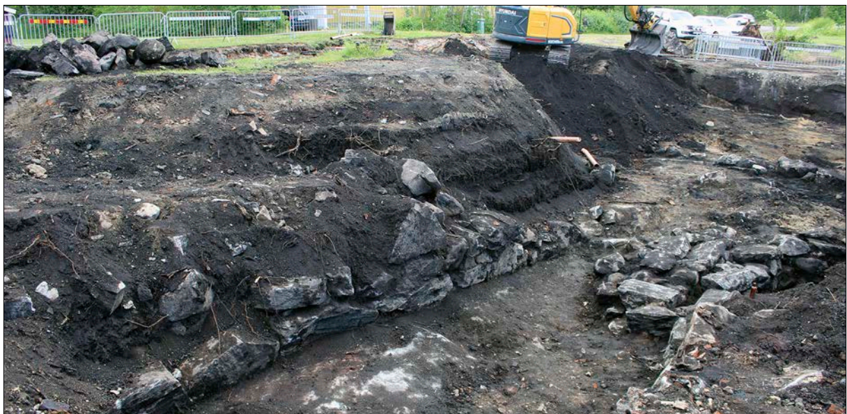
Figur 22. Grundmuren för kvarnen (104) till vänster och vattenhjulsfundamentet (111) till höger i bild. Foto från nordväst.
