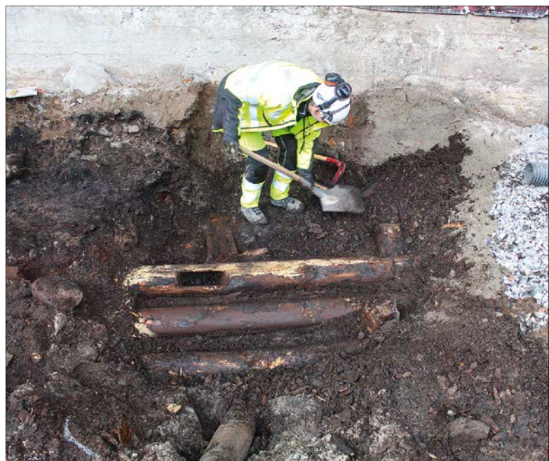
Figur 17. Delar av krubbväcket med omgivande kulturlager grävs fram (67 och 68). Här består det av ett knippe med liggande timmer förankrade med två bjälkar upp mot den forna klippstranden som gick längs med betongmuren i bildens bakgrund. Timmerknippet är säkrat med stående stolpar, möjligen återanvända stolpar från tranbodarna. I en av stockarna syns också ett uttag, möjligen spår av en äldre konstruktion från vilken timret är återanvänt. Foto från norr.
