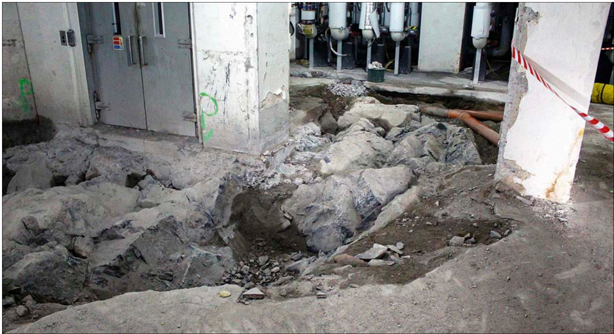
Figur 12. Yta A var den del som gjordes i KF-husets källare. I bilden syns hur man under 1930-talet har makat ur delar av berget och sedan lagt stenkross och gjutit betong över. Eventuella markhorisonter och arkeologiska lämningar har då försvunnit. Foto från väster.
