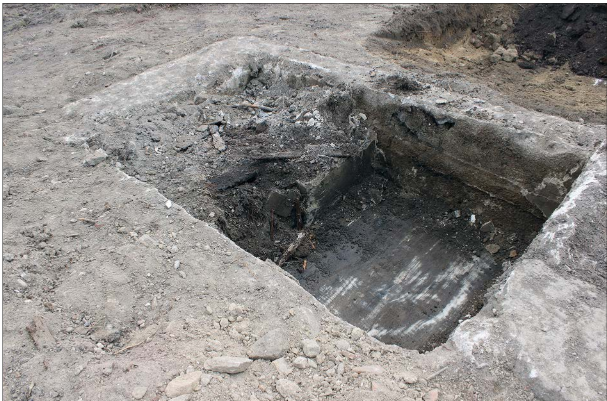
Figur 19. Gjuten källargrund i betong (200:1). I förgrunden syns det ena källarrummet tömt på utfyllnadsmassor och till vänster i bild anas dörröppningen till angränsande rum. Foto från NV.
