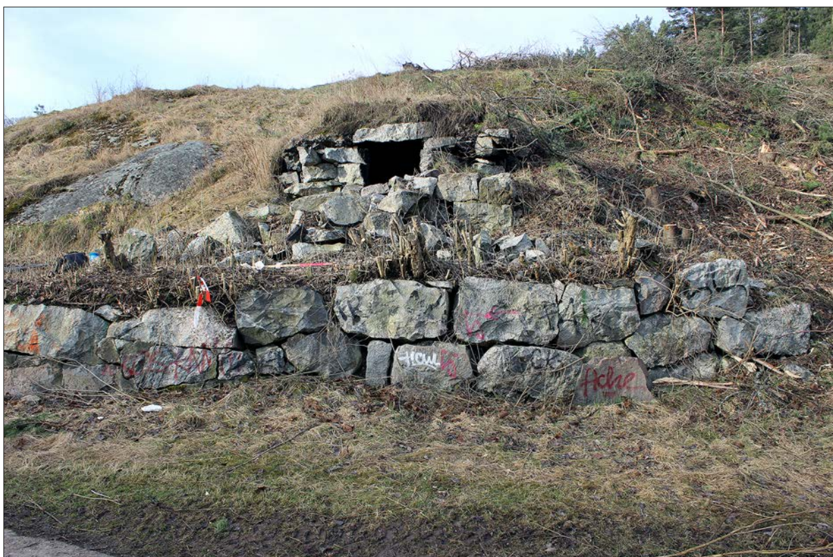
Figur 15. I bakgrunden syns jordkällare 178 och i förgrunden visas vägrampen 179 och 180 som gick förbi jordkällaren och ledde till Wålberga gård i norr. Foto från NÖ.
