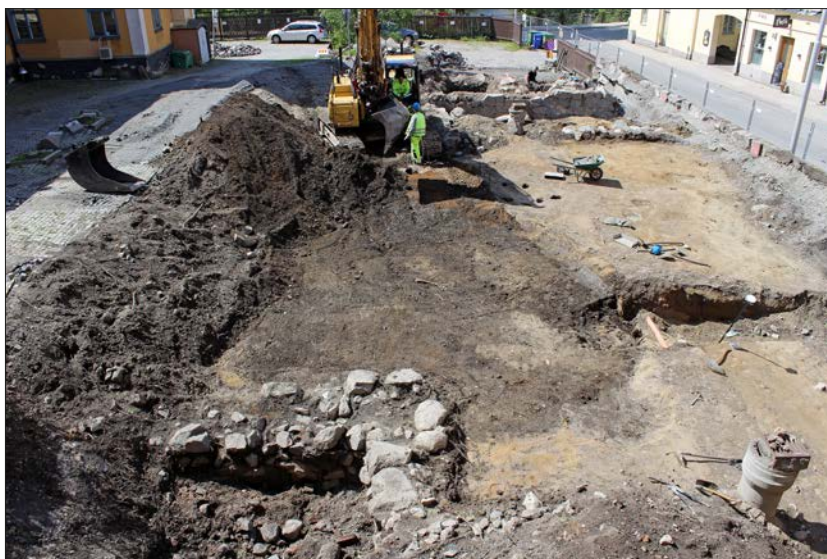
Figur 61. Grustäkt KN 198 schaktas fram. I förgrunden visas en källargrund (grupp 10) från andra halvan av 1500-talet. Källaren skär täktens SÖ del. Foto från Ö.
