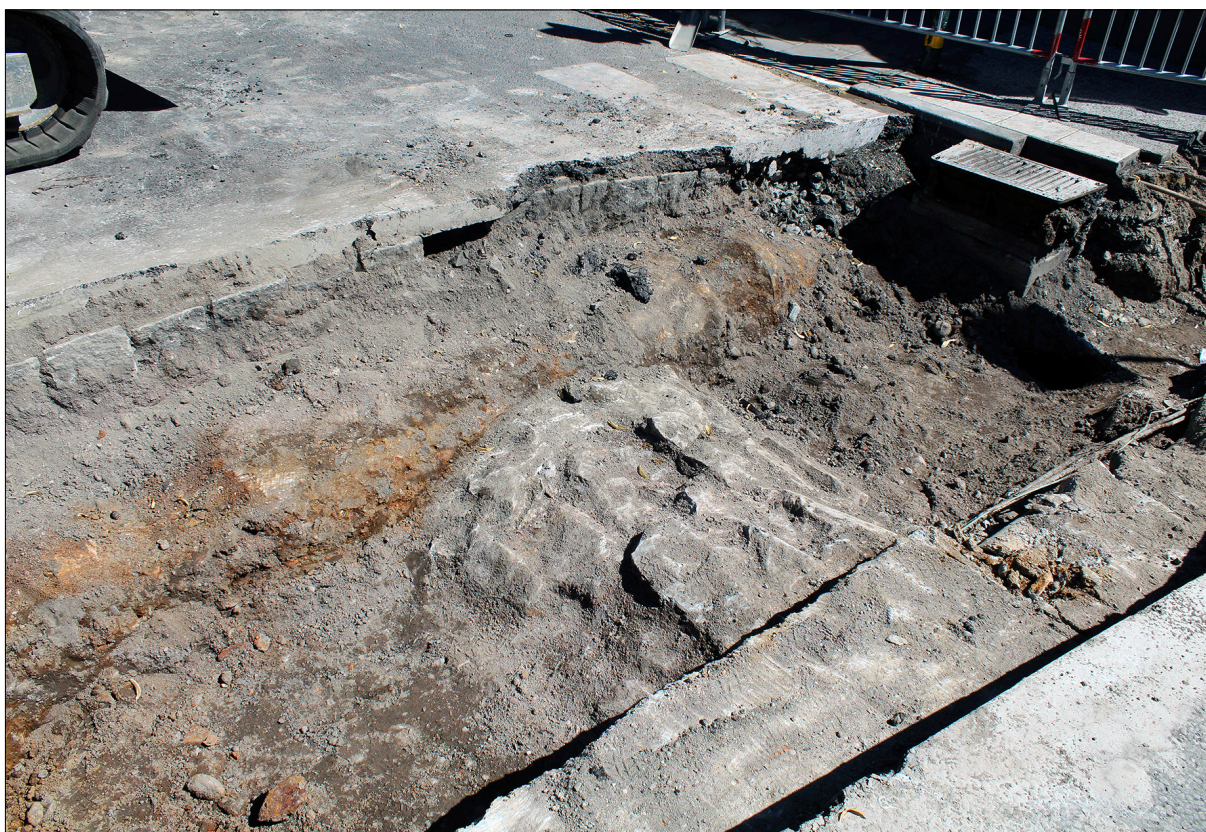
Figur 6. Murad avloppsledning i sten (kontext 601) från sent 1800-tal som påträffades i schakt 6. Foto från nordost.
