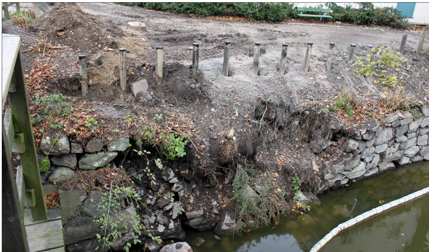
Figur 10. Schaktningen påbörjad vid strandskoningen i öst, delar av strandskoningen hade dock rasat ned vid arbetet med boringen av stagrören. Foto från söder.
