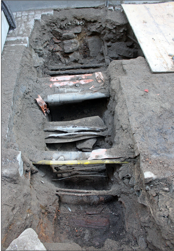
Figur 17. Översikt över den södra delen av schaktet i Prästgatan. Längst ned i bild syns den trärest som framkom i schaktbotten, kontext 132. Foto från öster.
