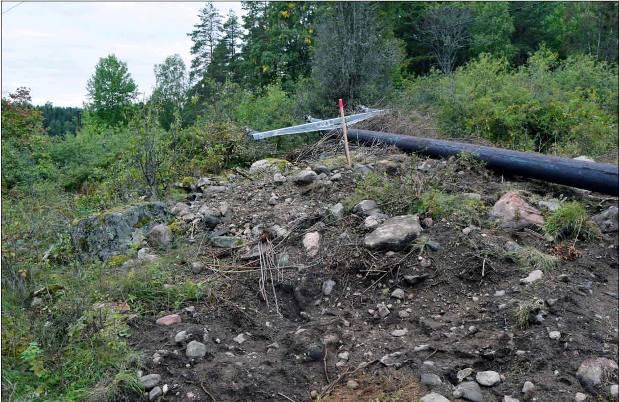
Figur 20. En stensättning, L1983:1938/Svärta 90:1, skadades vid schaktarbete där arkeolog ej var närvarande. Foto från sydost.
