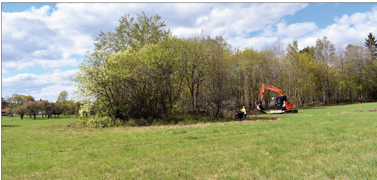
Figur 13. Söschaktning i den svagt sydostsluttande åkermarken vid L2013:8144. Den nyregistrerade skärvstenshögen ligger på impedimentet centralt i bild. Till vänster skymtar Viks gård. Foto från öster.
