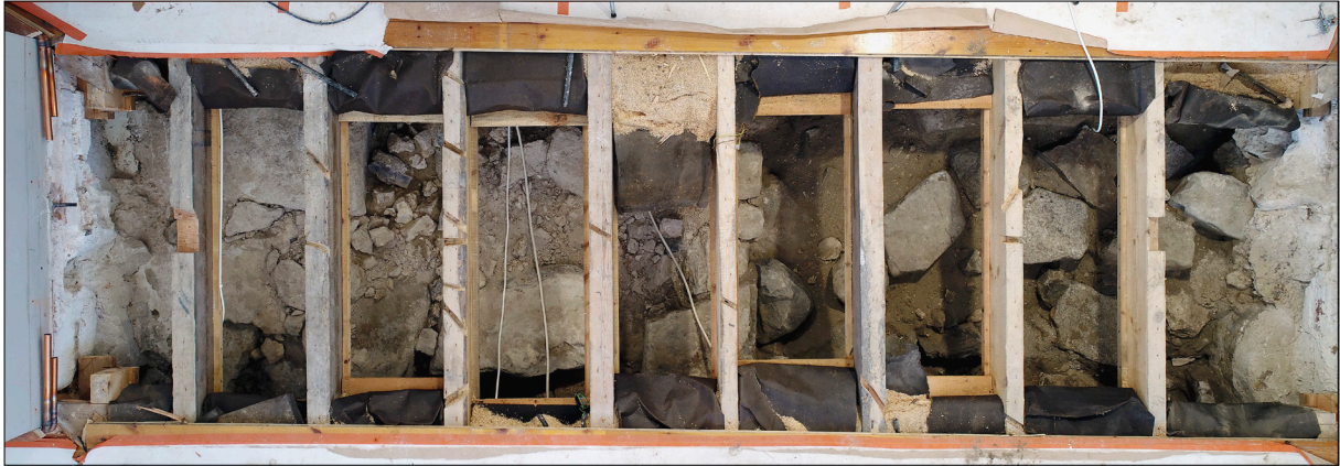
Figur 11. Lodfoto över murresterna vid den södra korsarmen. Mitt i bilden synd skarven mellan den äldsta muren (till vänster) och muren som tillkom under tillbyggnaden på 1500-talet (till höger). Norr är uppåt i bild.
