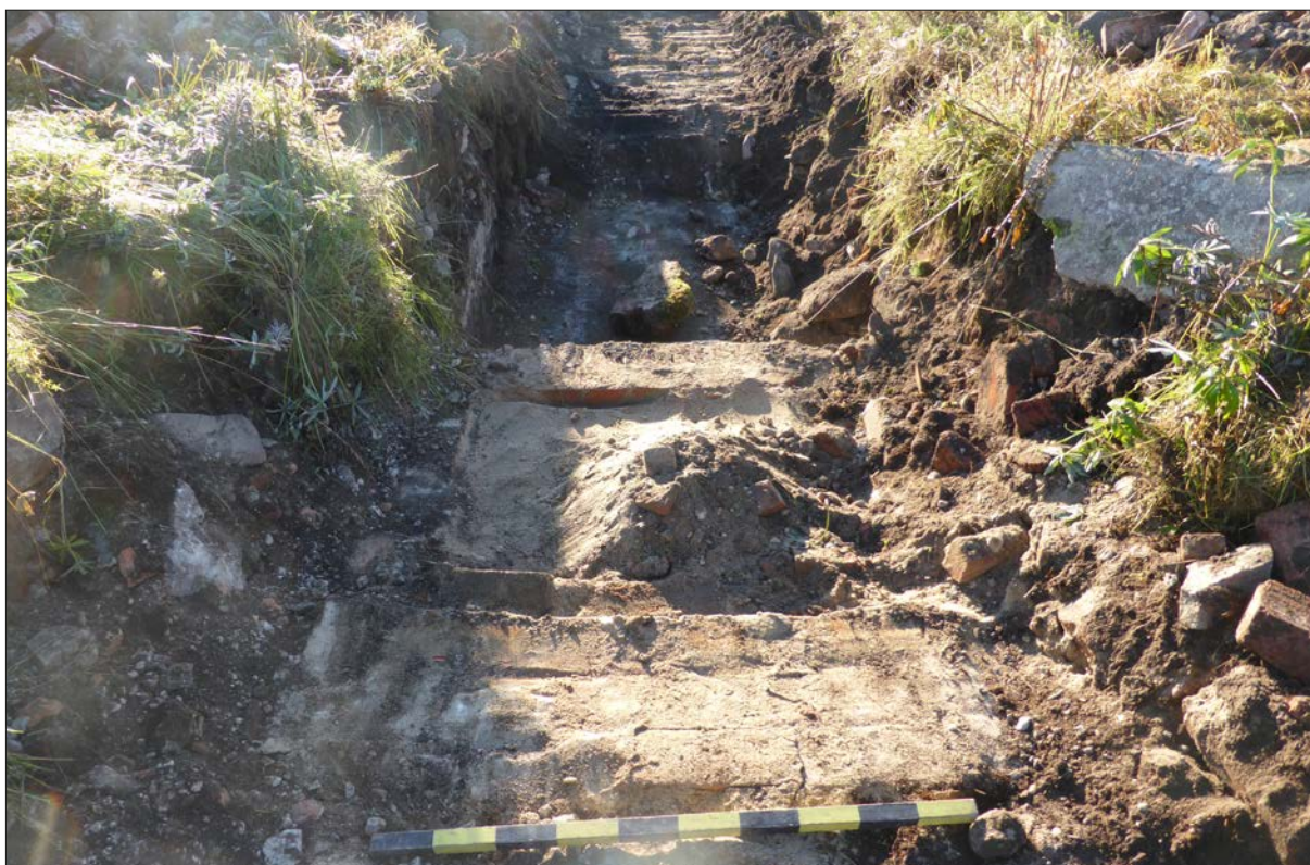
Figur 17. Schaktet genom det senaste boningshuset med grunden till murstocken i förgrunden. Foto från V.
