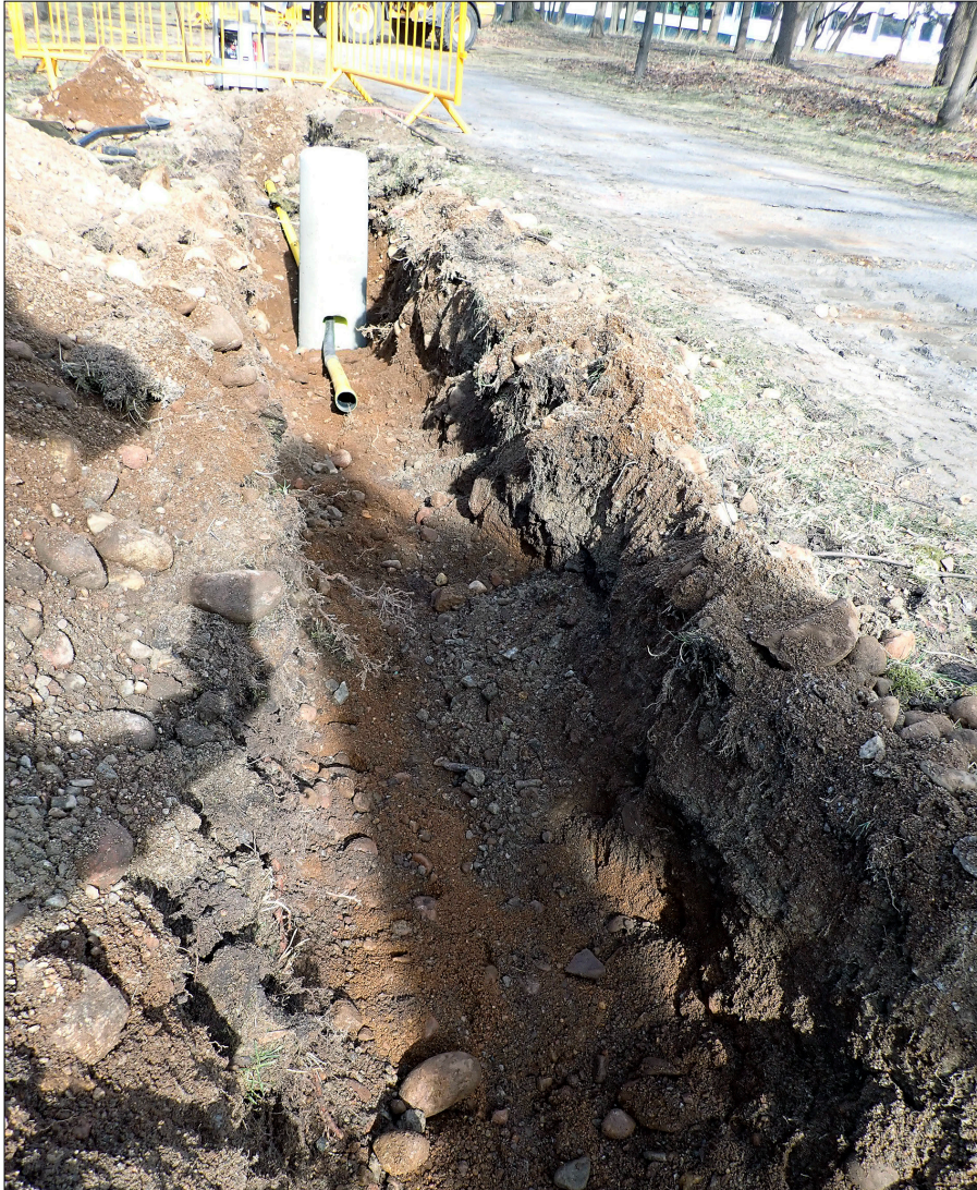
Figur 10. Schakt 3 med ett lyktstolfundament och kabelrör placerade i schaktet. Foto från söder.
