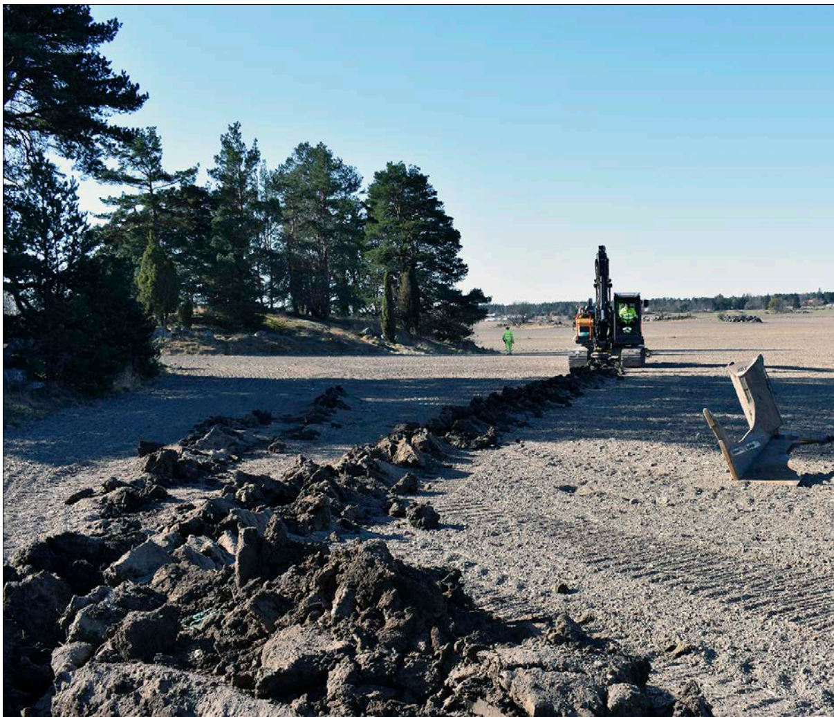
Figur 11. En stor del av undergrunden inom fastigheterna Gånsta 3:4 och 3:14 utgjordes av åkermark vilket innebär att kabeln kunde plöjas ned. Här visas kabelnedläggningsarbetet. Foto från nordöst.
