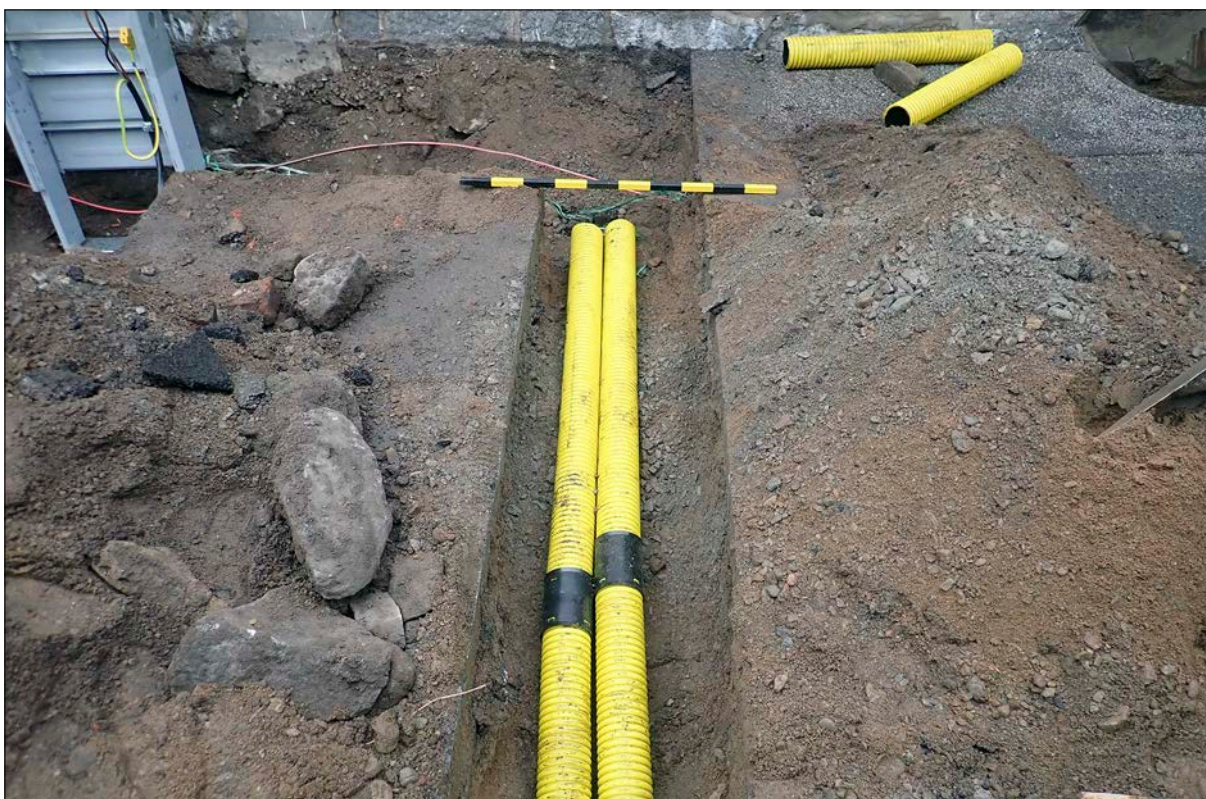
Figur 6. Södra änden av schaktet, ny elledning lades tvärsöver Långgränd mellan fastigheterna Trädgårdsmästaren 3 och Brasan 6. Foto från väster.
