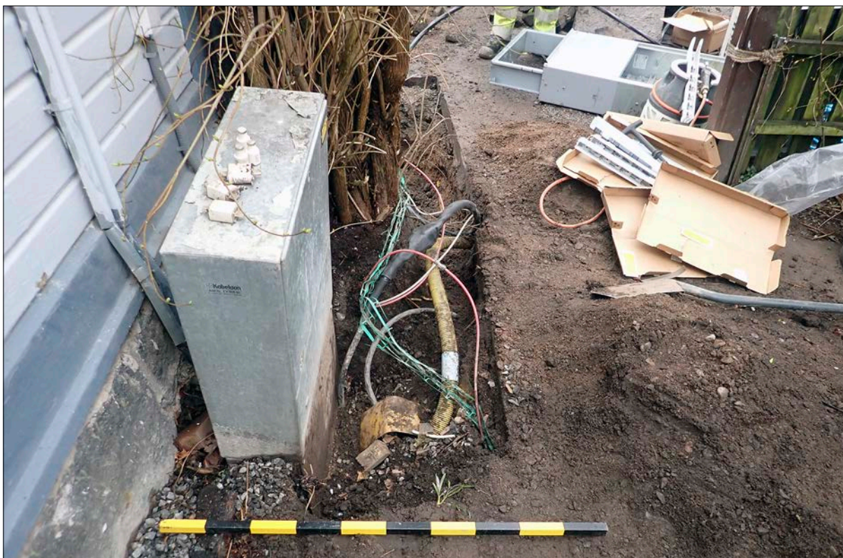
Figur 5. I schaktets nordöstra hörn grävdes befintliga kablar fram kring äldre elskåp. Foto från öster.
