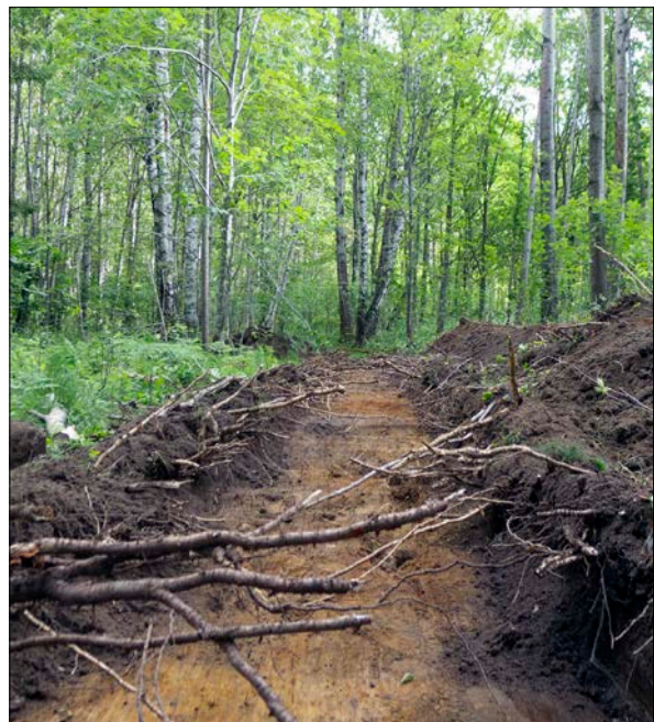
Figur 12. Sökschaktning av schakt 503 i en skogsglänta där grävmaskinen lyckades ta sig in. Foto från väster.
