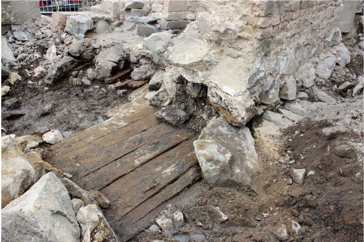
Figur 138. Rustbädden under källarmurarna bestod av kraftiga plank som vilade på nedslagna pålar och var fortfarande i gott skick när de togs fram.
