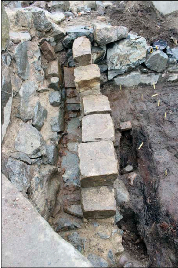
Figur 166. Rännan sluttade mot öster och var uppbyggd i hörnet mellan två äldre murar. Troligtvis har den använts för avrinning från ovanliggande vägbroar. Foto taget från öster.
