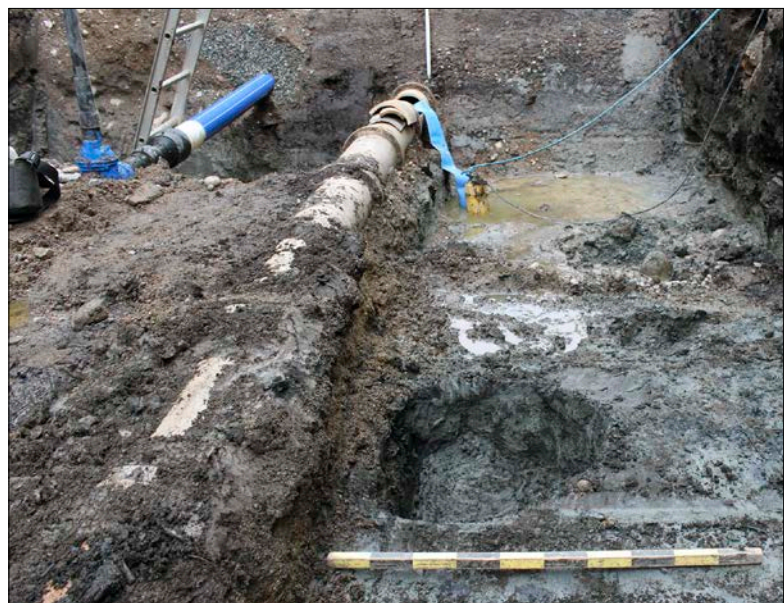
Figur 104. Utsikt över schaktet en blöt dag. I förgrunden syns grop 1010 invid ledningen som ska bytas. Foto från nordöst.
