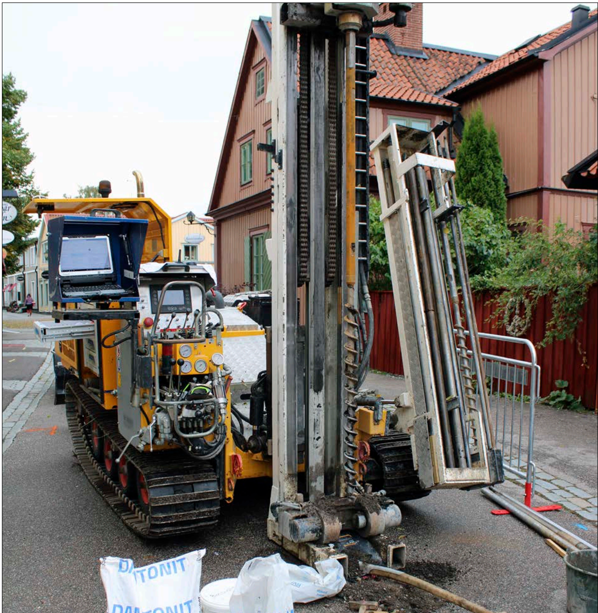
Figur 5. Översiktbild vid borrhpunkt 107 innan borrhålet återfyllts med bentonitpellets. Foto från ost – nordost.
