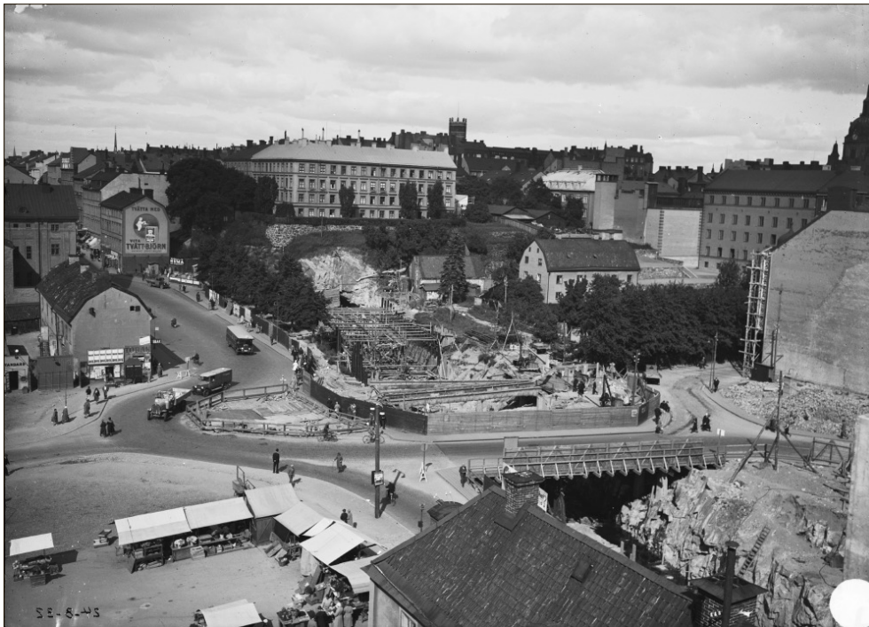
Figur 6. Schaktningarna för tunnelbygget på 1930-talet var omfattande. Bilden från 1932 visar tunnelns sträckning förbi Björns Trädgård som är det trädbevuxna området till höger i bild (Stockholmskällan, SM2019-824-1767660395).
