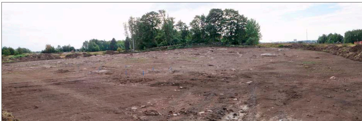
Figur 30. Område 3 efter avbaning. Närmast i bild är det treskeppiga huset markerat med blå stakkeppar. Fotograferat från norr.
