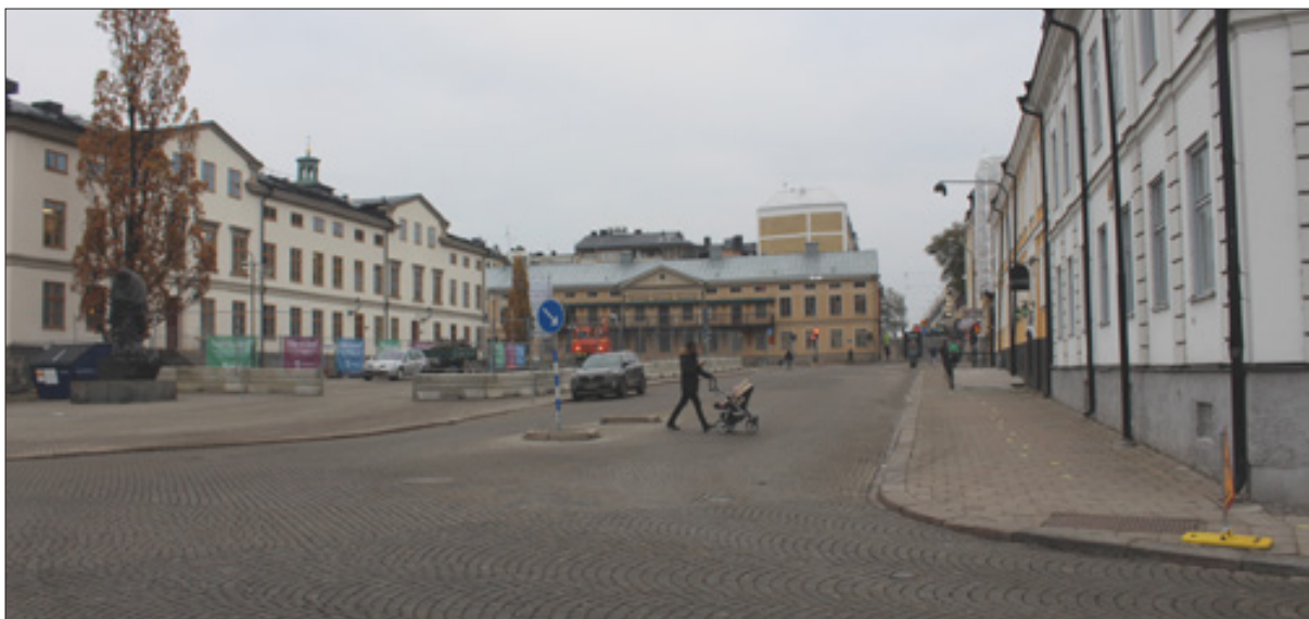
Figur 6. Gamla Torgets södra del med Repslagaregatan centralt i bild. Till vänster i bild syns Eschelsonska huset. Grävmaskinen arbetar vid schakt 1001. Foto från V.
