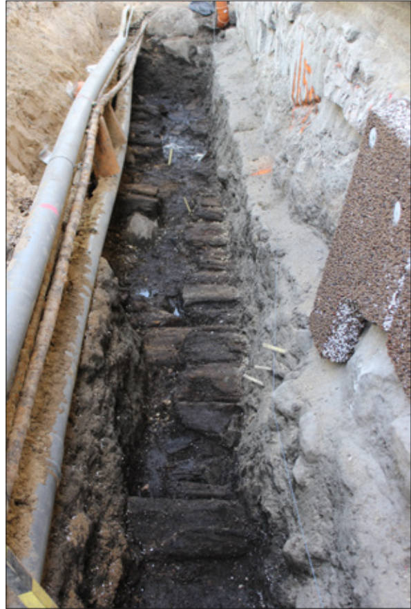
Figur 28. I bildens vänstra sida syns den kavelbro som utgör Stora Gatan. Kavelbron till höger utgör den tvärgänd som går mellan tomterna ner mot vattnet. Foto från SV.
