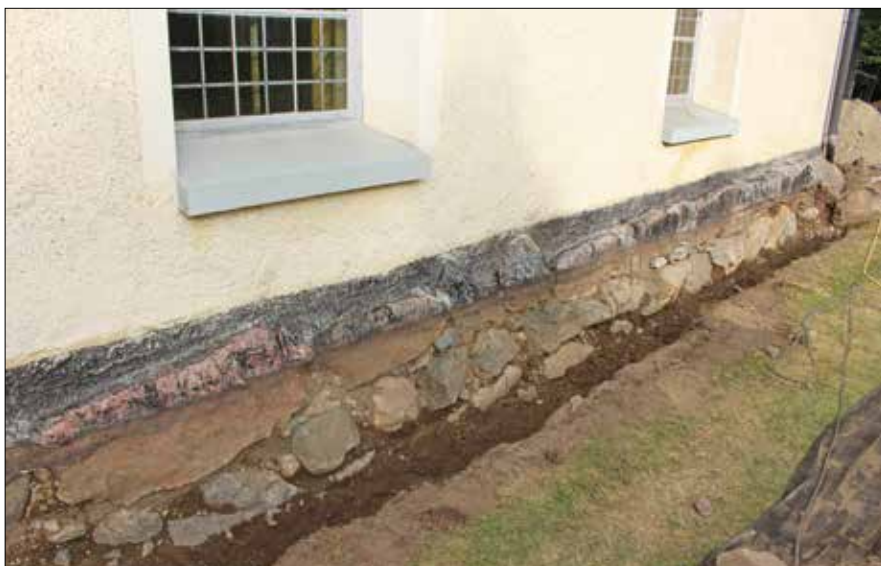
Figur 5. Yttre delen av långhusets södra sida. Det var oklart om muren 102 skulle tolkas som resterna av en äldre mur eller en grundläggning till kyrkans östra del. Ovanför 102 går det att se hur delar av mur 101 har varit synliga ovan mark. Foto från SV.
