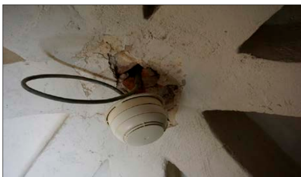
Skada i putsen i valvet ovan orgeln. Har lagats ut med kalkputs samt retuscherats med kalkfärg.
