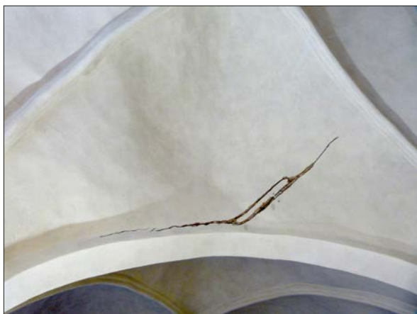
Figur 3. Sprickan i norra sidoskeppets västligaste valv hackades upp ytterligare och lagades med genomgående järn och nät.
