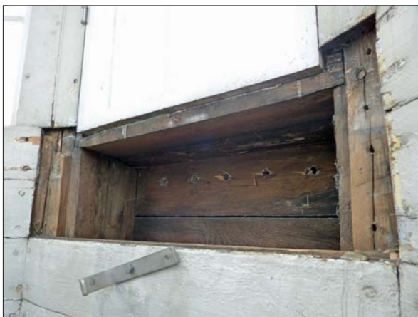
Figur 16. Bild 47. Lanterninens panel lösgjordes för kontroll av eventuella rötskador. Virket var i god kondition och borrhål fungerade som luftning. Bakom panelen låg en lapp från föregående renovering av fönstren, 1986.
