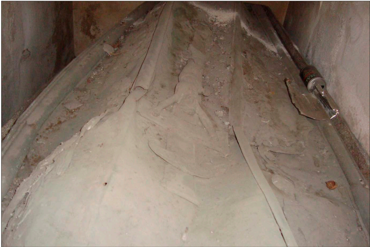
Locket är kraftigt deformerat och nedsmutsat. Aluminiumburken är troligtvis inslängd genom någon av de utvändiga ventilationsluckorna. Foto: Cai Zetterström
