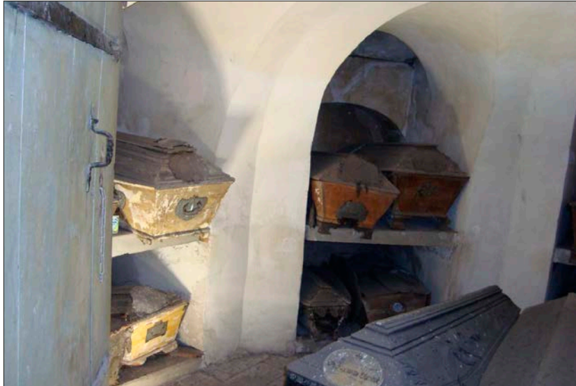
Träskistor med bemålning uppvisar fuktskador. Foto: Cai Zetterström
