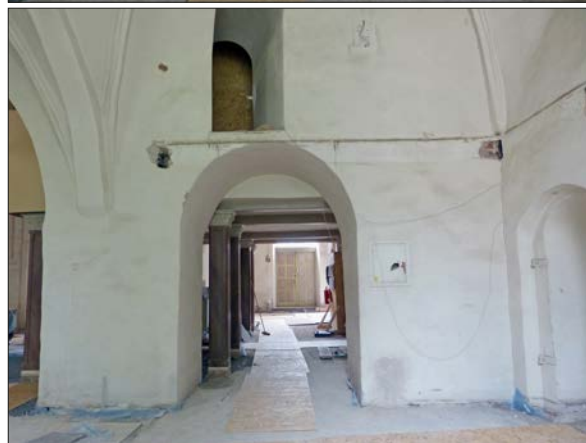
Figur 4. Norra skeppet. I samband med bytet av läktartrappa kunde västvæggen beskådas. Konturen efter den gamla trappan syns i putsen. På den nedre bilden syns den södra väggytan med öppningen till orgelläktaren.
