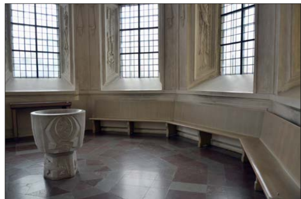
Figur 9. Hackerska koret före renovering. Väggytorna och stuckaturen var kraftigt nedsmutsad.
