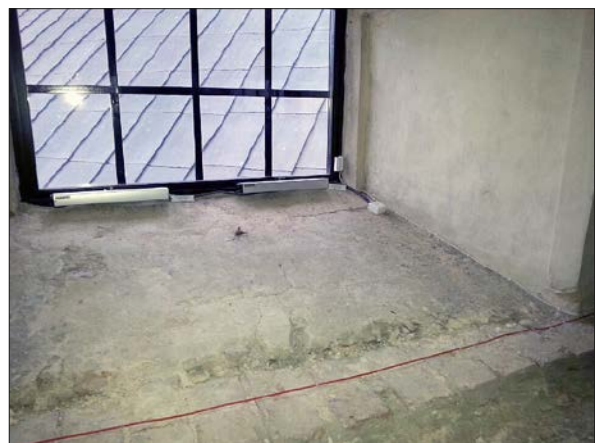
Figur 55. För att möjliggöra ett jämnare klimat i Hackerska gravkoret ersattes de två nordliga fönsterbågarna av två nya öppningsbara fönster. På samma nivå i fönsternischerna monterades även linjedetektorer för brandlarm.
