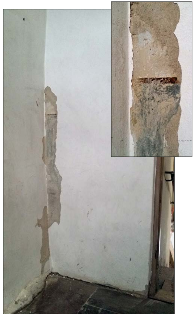
Figur 8. I nordvästra hörnet framkom spår efter tidigare bröstning. En referensruta lämnades kvar. Samma typ av bröstning iaktogs även i vapenhuset. Infällt: Detalj av färgspår för äldre bröstning i Lovisinska.
