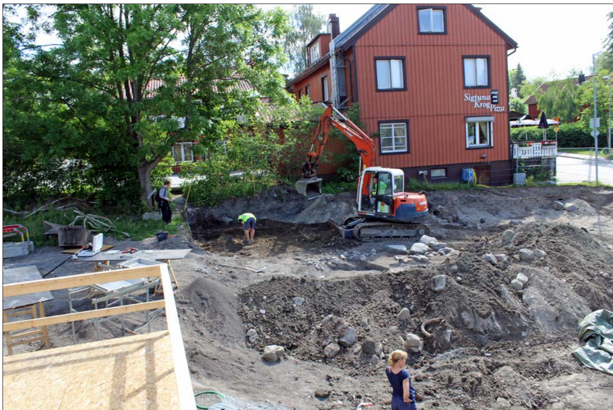
Figur 27. Det var en närmast omöjlig utmaning att knyta samman den västra och östra delen av ytan till följd av de omfattande störningarna i den centrala delen. Bensintanksgropen fylldes under utgrävningens gång av alltmer dumpmassor. Foto från väst (visningsrampen).
